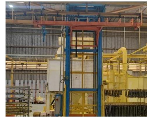
Elevador de carga para Pintura de Campo Grande
