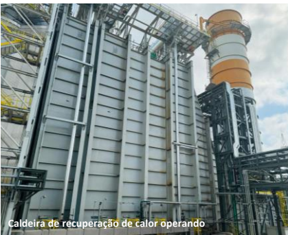
Caldeira de recuperação de calor operando
