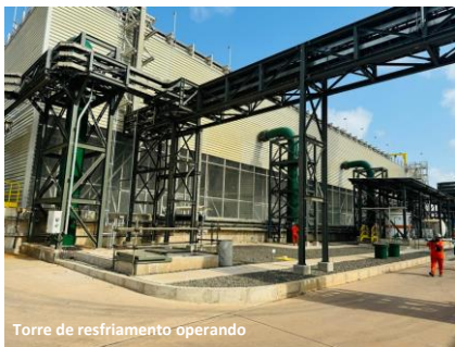
Torre de resfriamento operando
